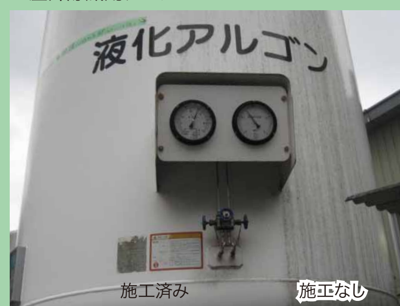
■屋外貯蔵用タンク
